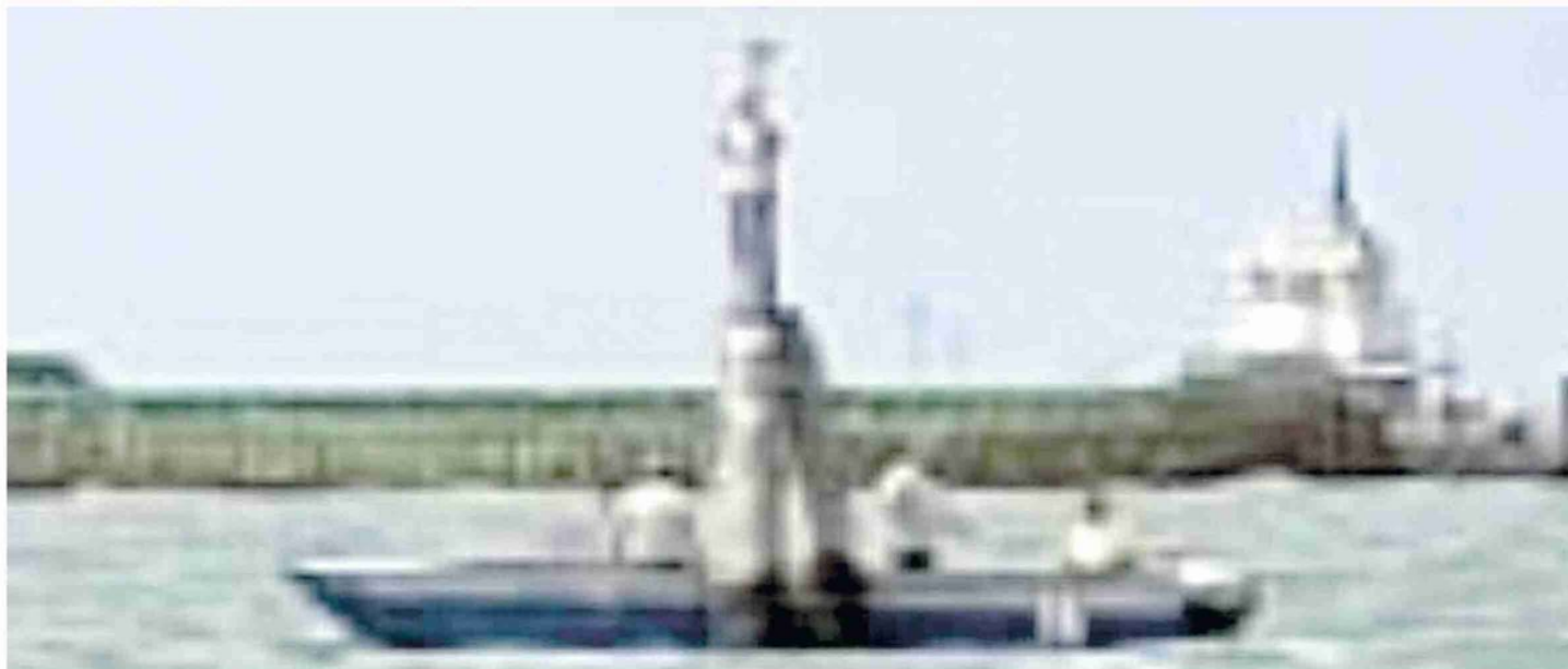
LAVORI IN CORSO Gli operai al lavoro su una delle bricole che delimitano il canale dell'Orfanello. Sotto, l'assessore ai Lavori Pubblici Francesca Zaccariotto
