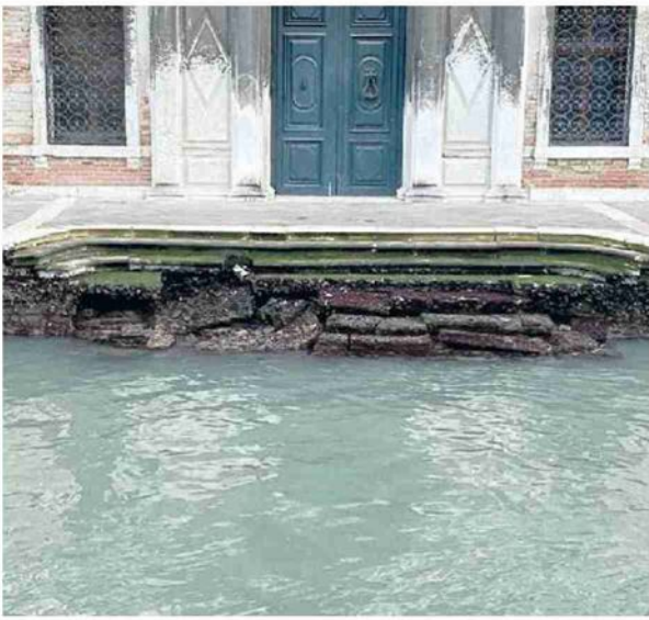
FONDATA DEL SOCCORSO Le conseguenze in rio dei Carmini
