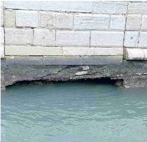
RIO DE LA PANADA Le onde hanno scavato sotto il palazzo
