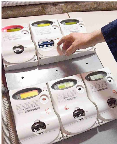
Contatori del gas e dell'energia elettrica
